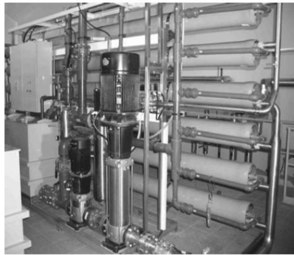
Fig. 3: RO unit in Perla, Usti nad Orlici
